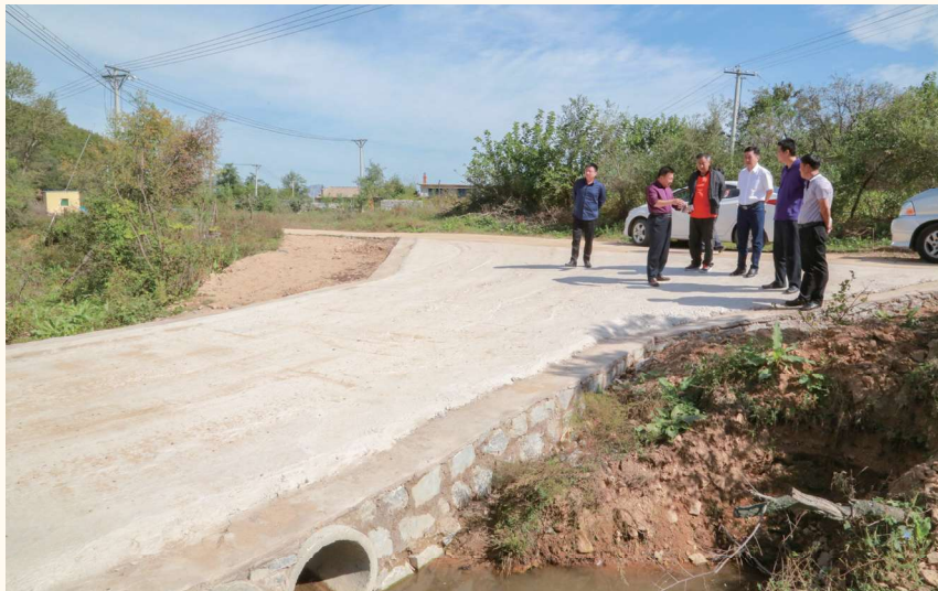
国家税务总局大连市普兰店区税务局援建墨盘街道王山头村漫水桥。
